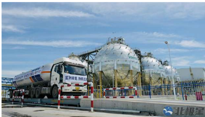
国家電投「大安グリーンアンモニア実証プロジェクト」のグリーンアンモニア貯蔵設備と連雲港での出荷作業
